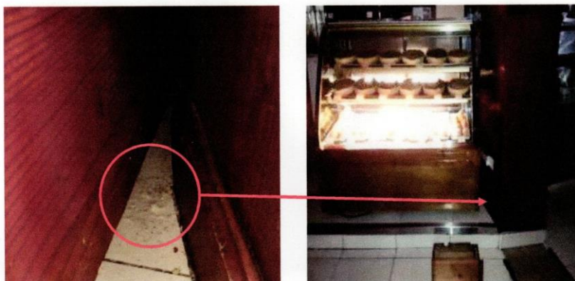
RESIDUOS ORGÁNICOS ENTRE EXHIBIDOR Y ESTRUCTURA DE MADERA.
