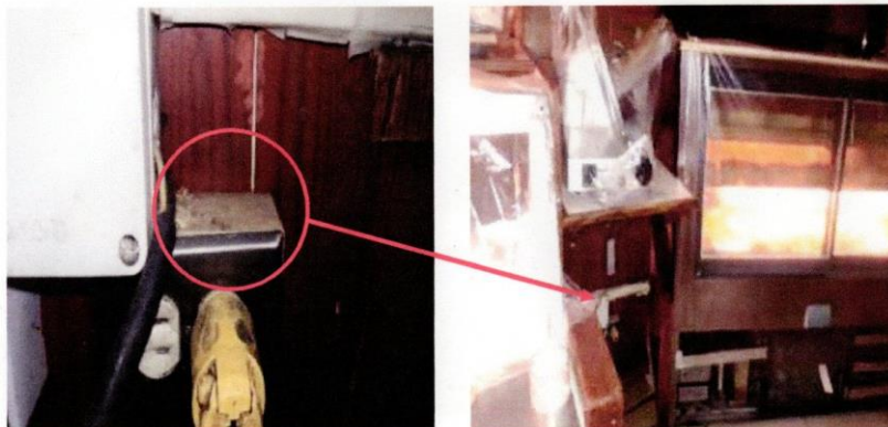
RESIDUOS ORGÁNICOS SOBRE TOMACORRIENTES.
