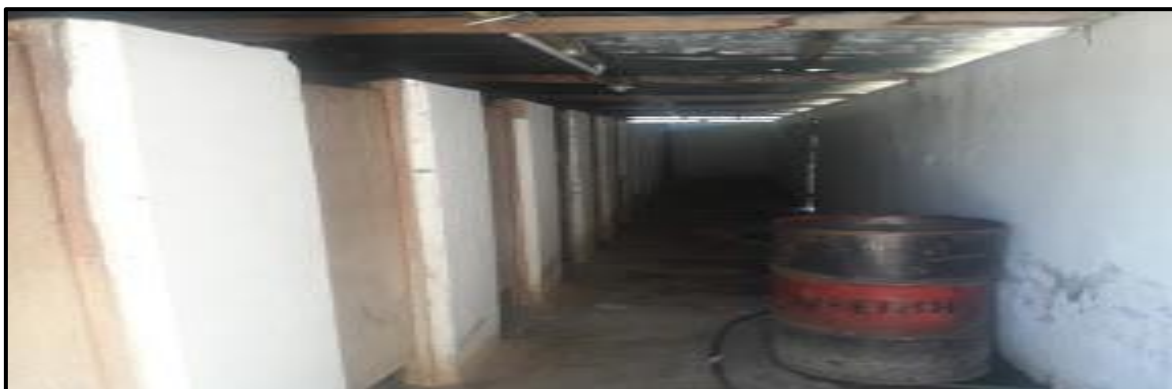
Figura 69. Baños de la comunidad en Catahuasi. Fuente: elaboración propia (2019)
