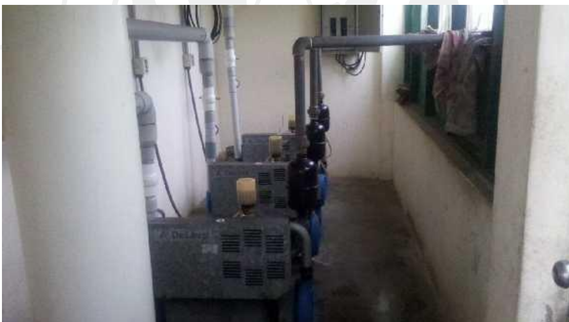
Imagen 12. Sistema de bomba de vacío.
